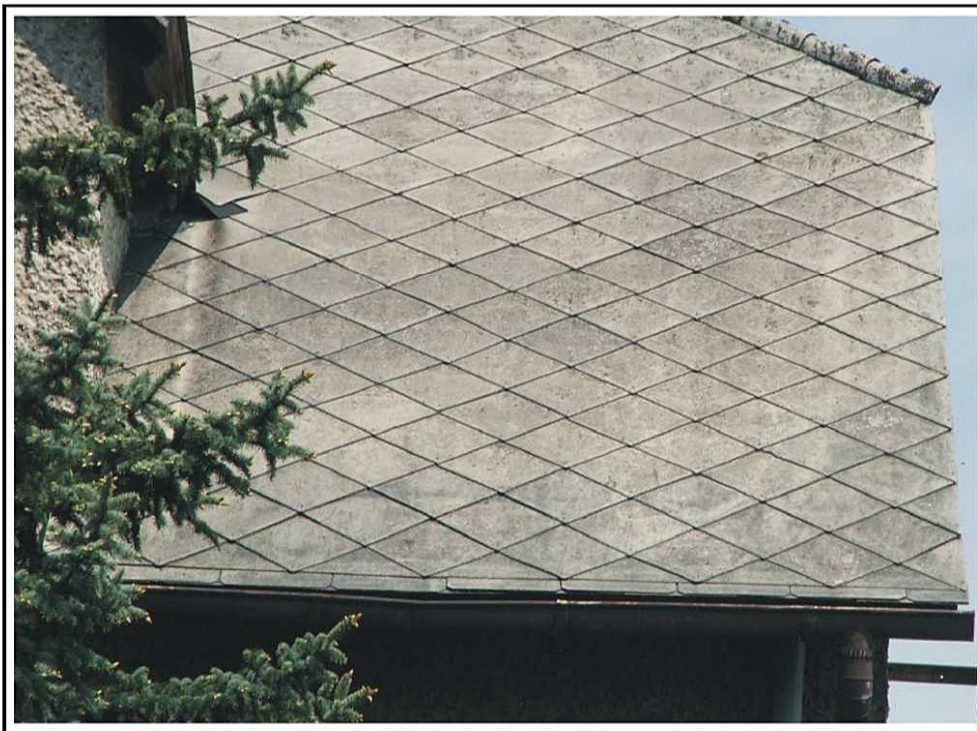
Fot.4 Pokrycie dachowe budynku mieszkalnego z płytek płaskich - III stopień pilności
